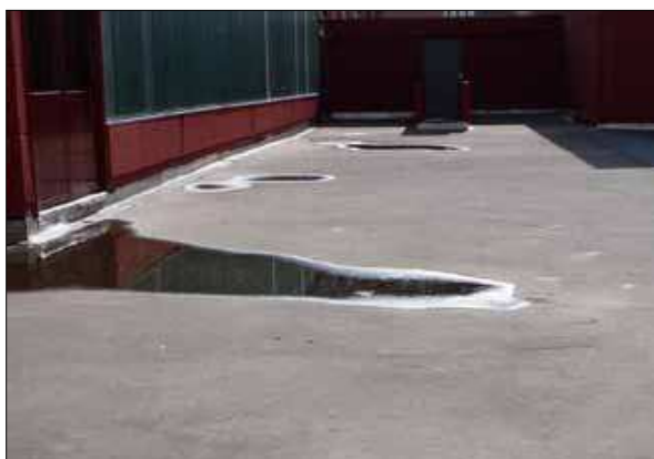
Parking avenue Claude Debussy : flaques d'eau qui demeurent longtemps après la fin de la pluie
